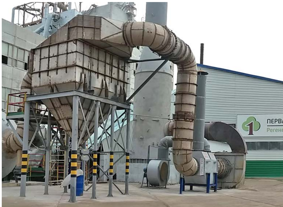
Установка регенерации катализаторов ИСХЗК
