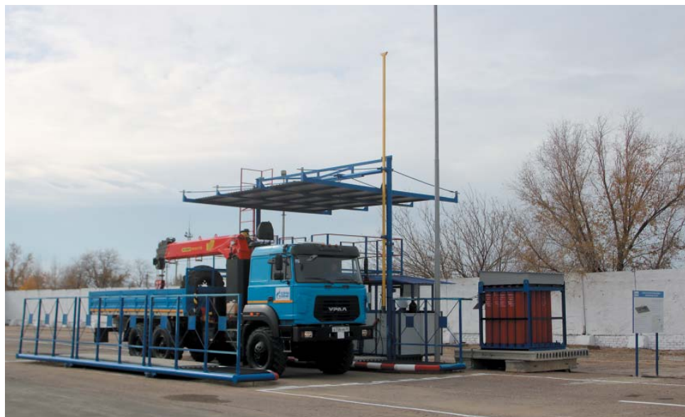
Осенью 2021 года на площадке Производственного комплекса № 2 УТТиСТ пущен в эксплуатацию «Пост контроля аккумуляции и сброса газа НО-160»
