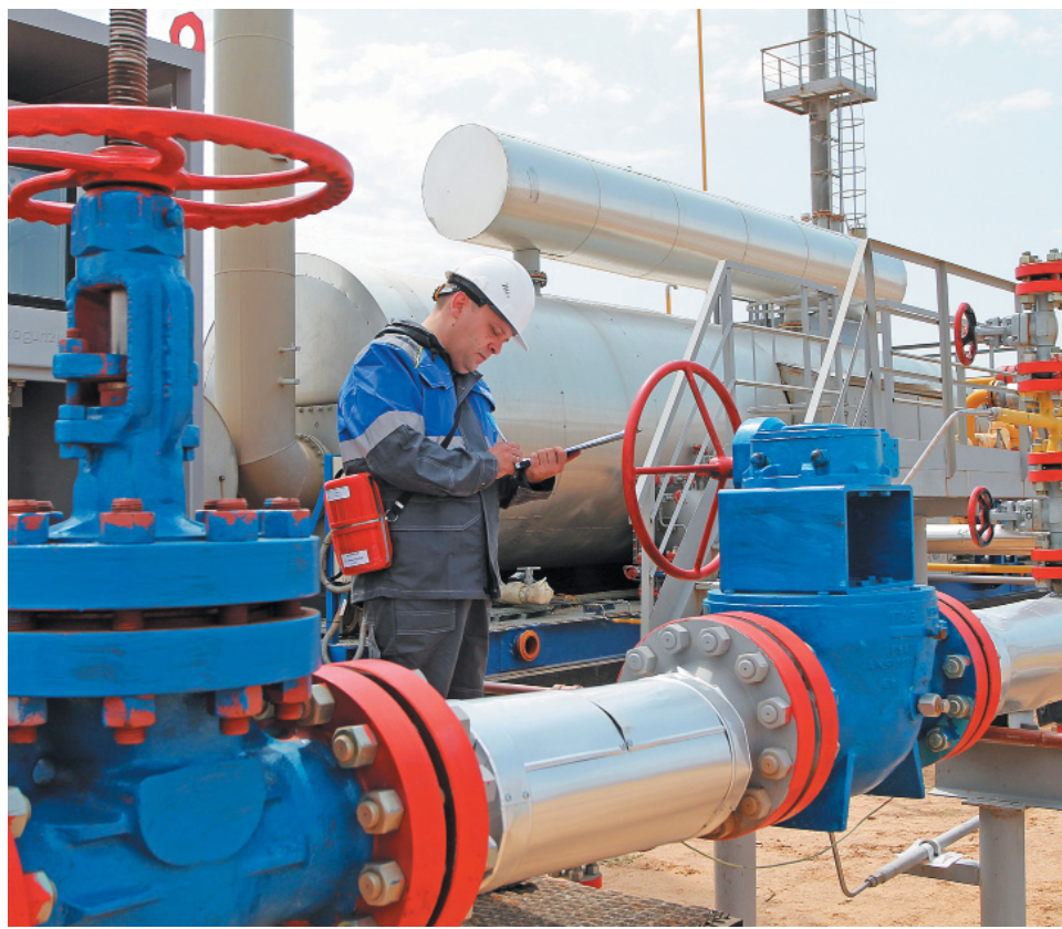
Начальник производственного отдела по добыче газа и газового конденсата ГПУ Александр Проничкин проводит административно-производственный контроль на эксплуатационной скважине
