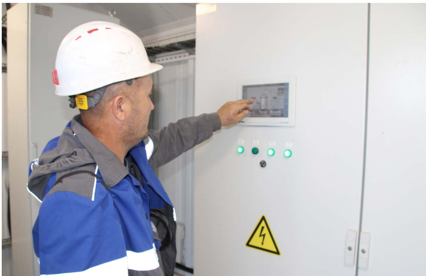
Пуск скважины № 630. Оператор по добыче нефти, газа и конденсата 6 разряда ЦДГиГК № 3 Рустам Ажмамбетов выводит параметры скважины на монитор и передаёт управление производственно-диспетчерской службе ГПУ, 8 августа 2023 года
