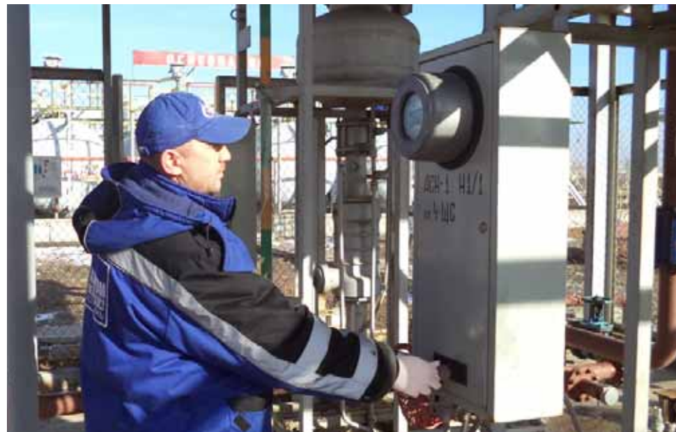
Перекачка метанола в резервуарный парк
