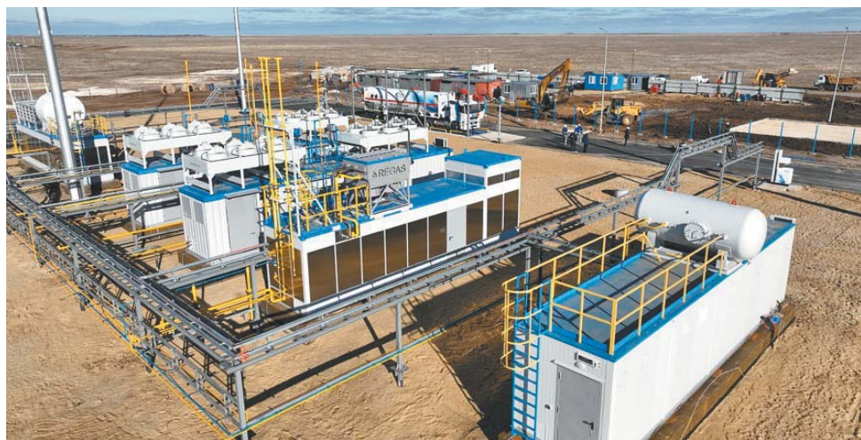
Малотоннажный комплекс по сжижению природного газа
