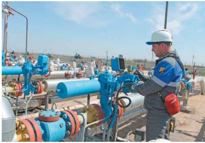
Подготовка манифольда к пуску скважины
