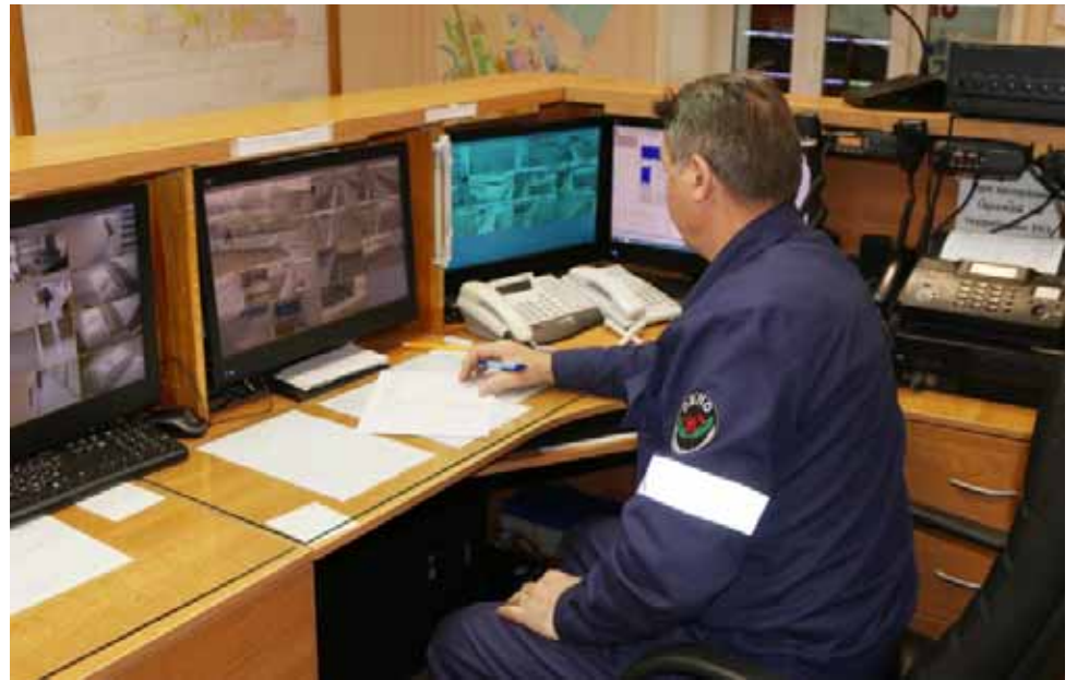
Центральный пост пожарной связи (ЦППС)
