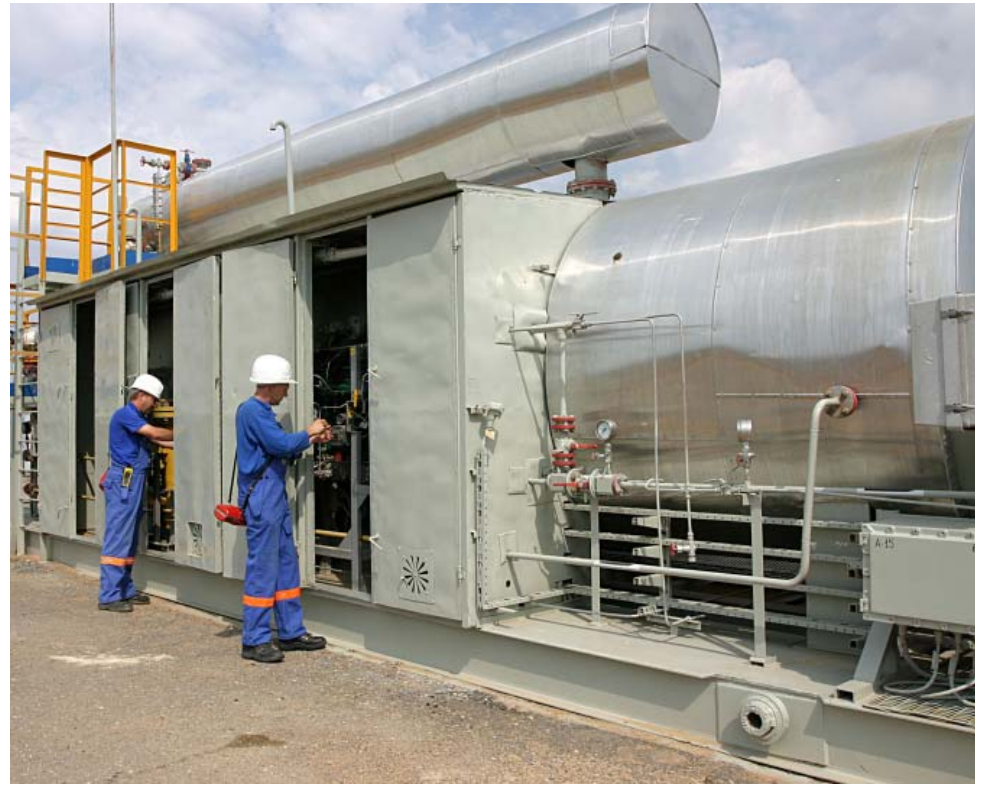
Настройка приборов автоматики устьевого подогревателя скважины 2090
